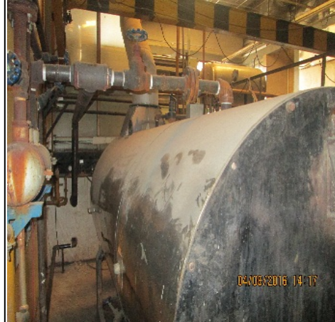
FOTO 4. CALDERA DE 30 BHP
