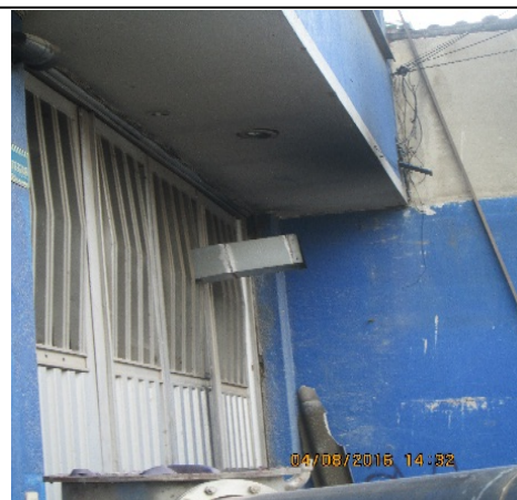
FOTO 10. DUCTO DE DESFOGUE DE LA PLANTA ELÉCTRICA
