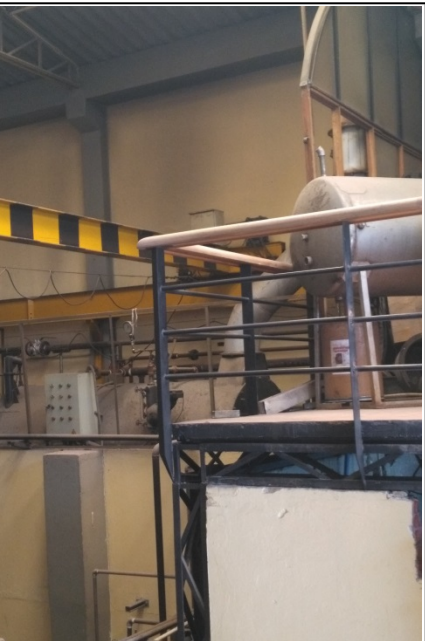
FOTO 5. CALDERA DE 30 BHP
