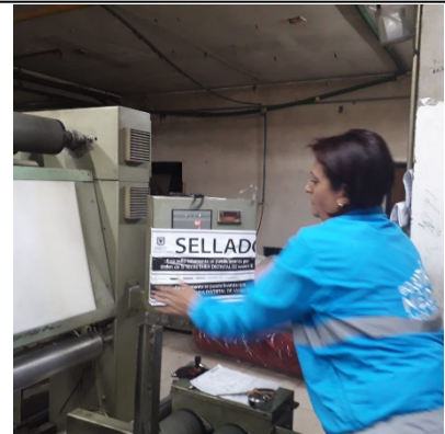
FOTO 4. IMPOSICIÓN DE SELLOS TABLERO DE CONTROL
