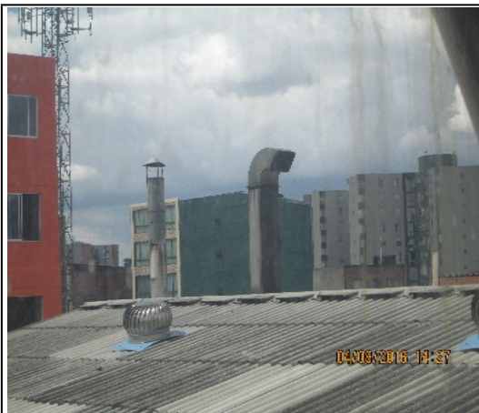
FOTO 7. DUCTOS DE LAS RAMAS DE TERMOFIJADO
