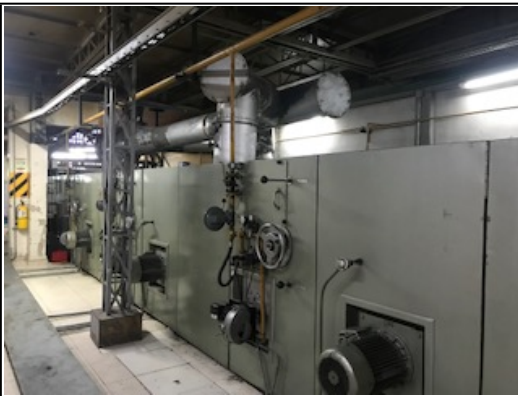
FOTO 3. RAMA DE TERMOFIJADO NO. 1 MARCA ERHAR LEIMER BRUCKNER
