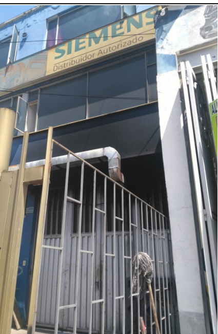
FOTO 5. DUCTO PLANTA ELECTRICA
